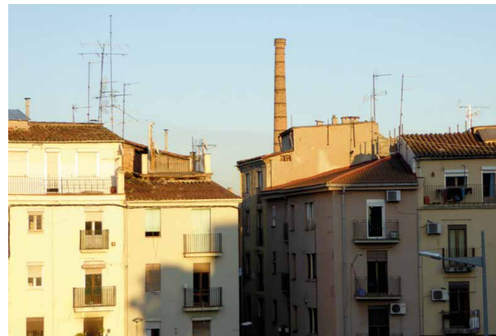
La majoria d'habitatge centenerari i deteriorat es concentra al centre històric.
